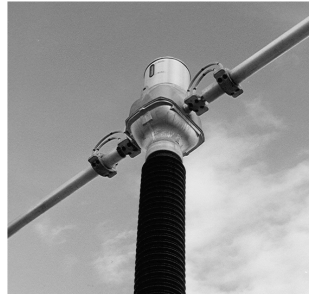
Transformador de intensidad 400 kV
